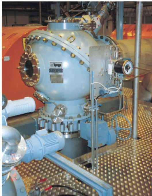
Filter Typ PR-BW 100 im Kraftwerkseinsatz
