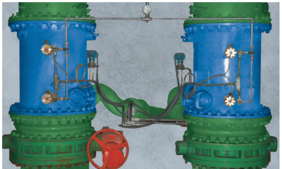
Filter Typ PR-BW 800-C im Kraftwerkseinsatz
