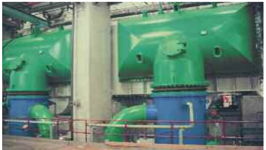
発電所設置のPR-BW800型フィルタ
